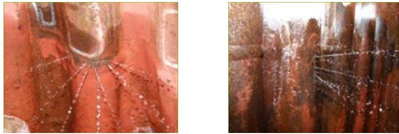
Abb. 1. Schäden durch Spannungsrisskorrosion im Kraftwerksbereich [3]
